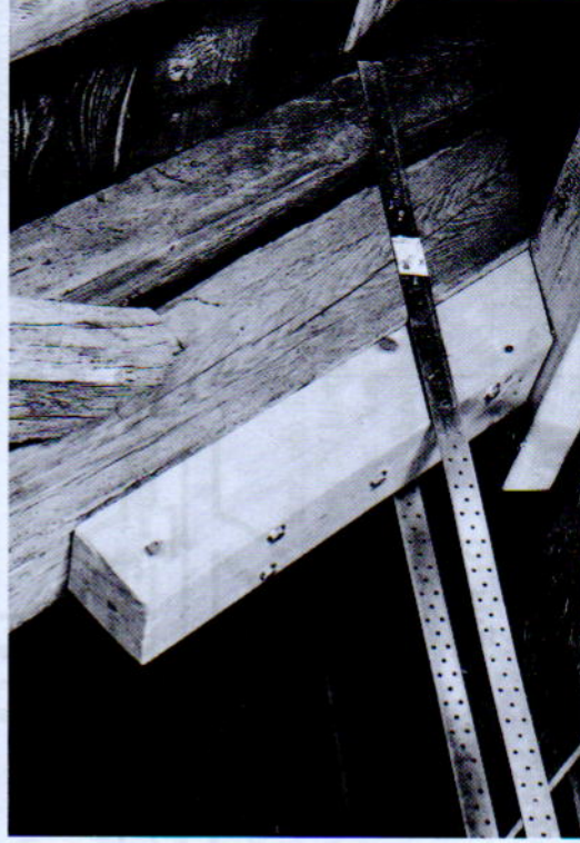
Auf dem Dachboden wurden die Balken samt Binderfuß mit Keil und Zug-Anker stabilisiert. Bilder von Bernd Bickelhaupt
